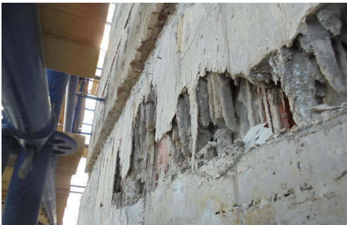
Фото 13. Неполное заполнение бетонного подстилающего слоя (набрызга) под облицовочными мраморными плитами.
