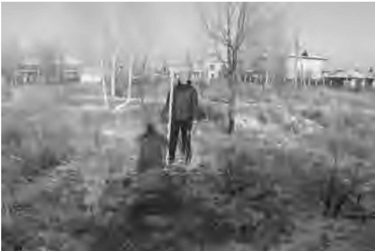
Илл. 34. Археологические разведки на земельном участке для расположения объекта «Строительство автомобильной дороги по проспекту Ленинского Комсомола от проспекта Туполева до ул. Генерала Кашубы в Заволжском районе г. Ульяновск». Вид с юга на разметку шурфа № 1.
