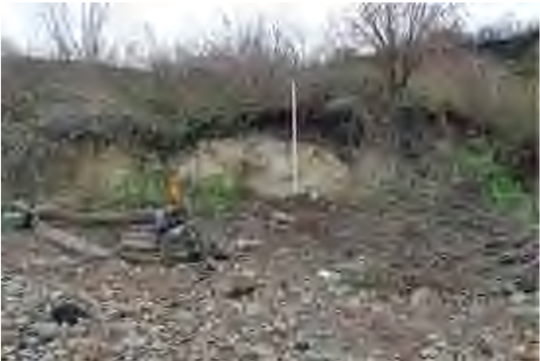
Рис. 12. Объект: «Берегоукрепительные сооружения на Куйбышевском водохранилище в районе с. Панская Слобода муниципального образования «город Новоульяновск» Ульяновской области». Вид с востока на зачетку № 2 оползневой массы.
