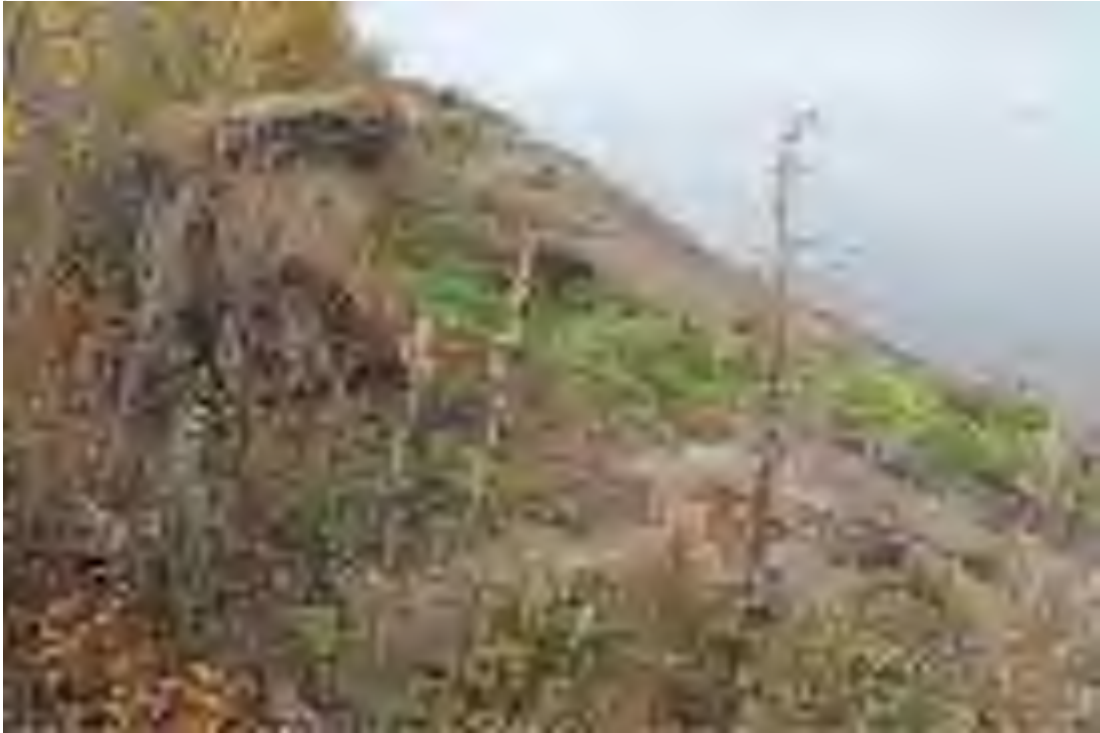
Рис. 9. Объект: «Берегоукрепительные сооружения на Куйбышевском водохранилище в районе с. Панская Слобода муниципального образования «город Новоульяновск» Ульяновской области». Вид с юга на береговой оползень и пляж.
