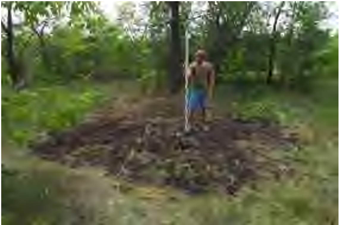
Рис. 15. Объект «МН Куйбышев-Унеча-2, р.Балашейка, 218 км, основная, DN1200. Реконструкция» в Сызранском районе Самарской области и Новоспасском районе Ульяновской области. Разведочный шурф I. Рекультивация. Вид с 3.
