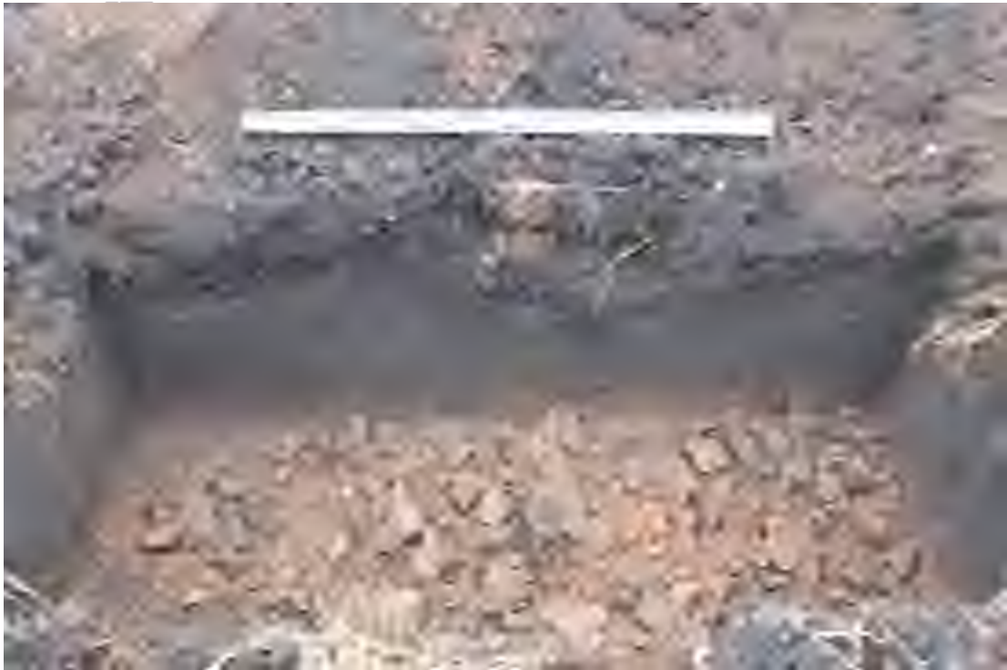
Рис. 13. Объект: «Нефтепроводы от задвижек скважин №№ 5, 10, 13 до АГЗУ куста скважин № 5 Новобессовского нефтяного месторождения» на территории Новомалыклинского района Ульяновской области. Вид с Ю на контрольную прокопку дна шурфа 2.
