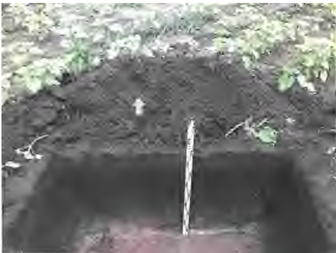
Рис. 77. Объект «Обустройство скважин №№ 50, 55 Кустовского месторождения». Северная стенка рекогносцировочного шурфа 6. Вид с юга.
