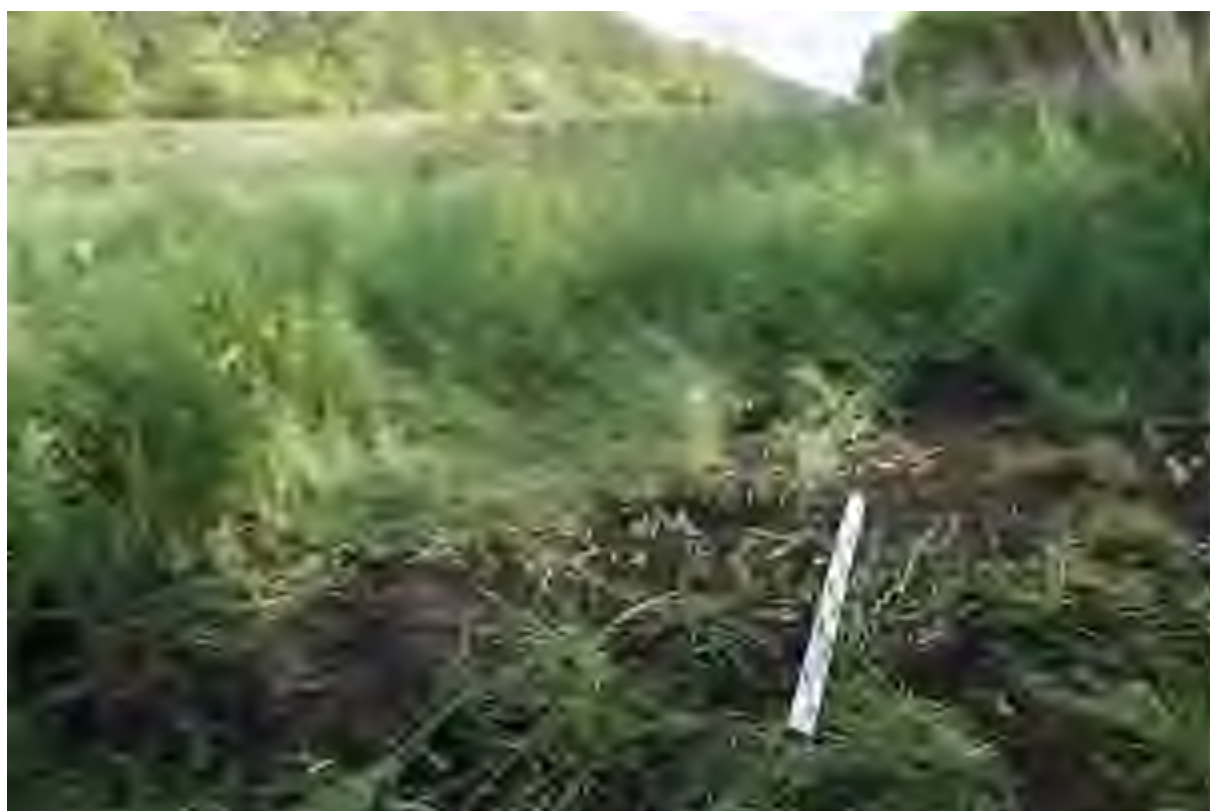
Илл. 31. Капитальный ремонт автомобильной дороги Р-178 Саранск - Сурское - Ульяновск на участке км 135+000 – км 142+000, Карсунский район, Ульяновская область. Шурф 7. Рекультивация. Вид с 3.
