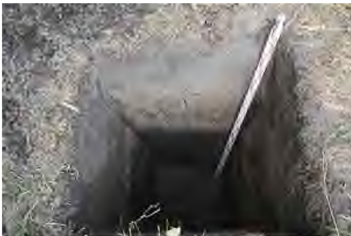
Илл. 18. Капитальный ремонт автомобильной дороги Р-178 Саранск - Сурское - Ульяновск на участке км 135+000 – км 142+000, Карсунский район, Ульяновская область. Шурф 3. Зачистка северного борга шурфа. Вид с Ю.
