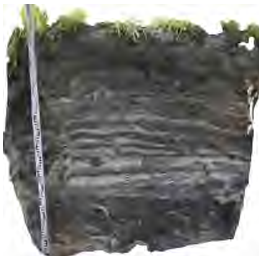
Илл. 14. Капитальный ремонт автомобильной дороги Р-178 Саранск - Сурское - Ульяновск на участке км 135+000 – км 142+000, Карсунский район, Ульяновская область. Шурф-защитка 1. Ортофотоплан разреза. Вид с В.
