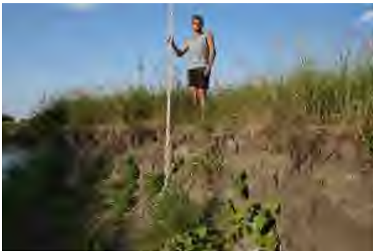
Илл. 15. Капитальный ремонт автомобильной дороги Р-178 Саранск - Сурское - Ульяновск на участке км 135+000 – км 142+000, Карсунский район, Ульяновская область. Шурф-зачистка 2. Место разбивки шурфа. Вид с Ю.
