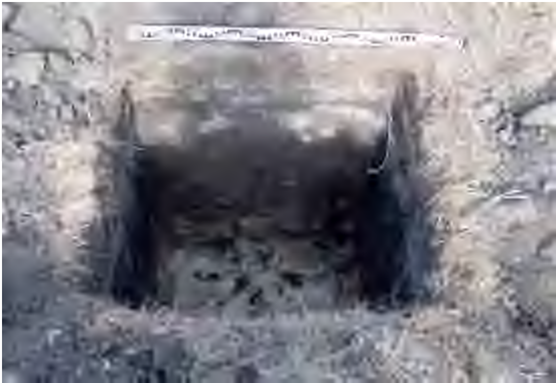
Рис. 13. Объект: «Высоконапорный водовод от задвижки скважины № 31 до задвижки скважины № 25 Варварского нефтяного месторождения» в Николаевском районе Ульяновской области. Общий вид с Ю на шурф 2.
