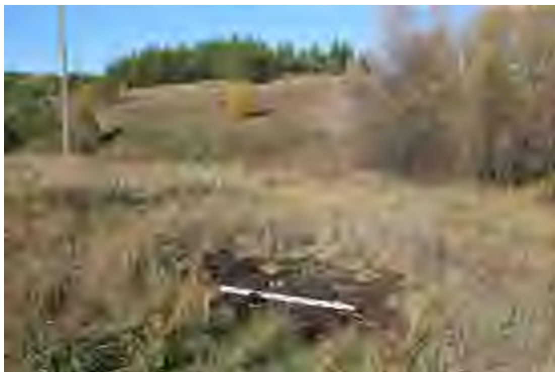
Рис. 88. Объект: «Газопровод межпоселковый от ГРС р.п. Тереньга размещения объекта: «Газопровод межпоселковый от с. Коржевка – с. Проломиха – с. Чамзинка Инзенского района Ульяновской области (код стройки 73/1521-1)». Вид с С на рекультивацию шурфа 15.
