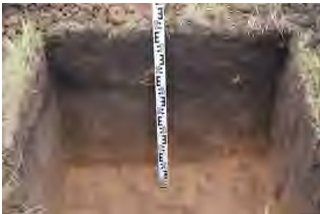
Рис. 30. Объект «Рекультивация полигона ТКО в районе села Красный Яр Заволжского района г. Ульяновска, Ульяновской области». Вид с 3 на стенку шурфа 5.
