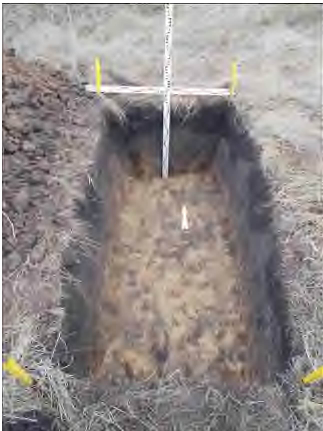
Рис 186. Земельный участок, отводимый под строительство объекта: «Газопровод межпоселковый...». Реконсцировочный шурф №12. Вид с Ю (ближний план)
