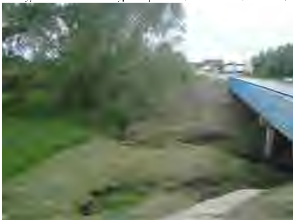
Рис. 7. Объект «Капитальный ремонт моста через реку Крака на км 110+400 автодороги Р-178 Саранск-Сурское-Ульяновск» в Сурском районе Ульяновской области». Вид с СВ
