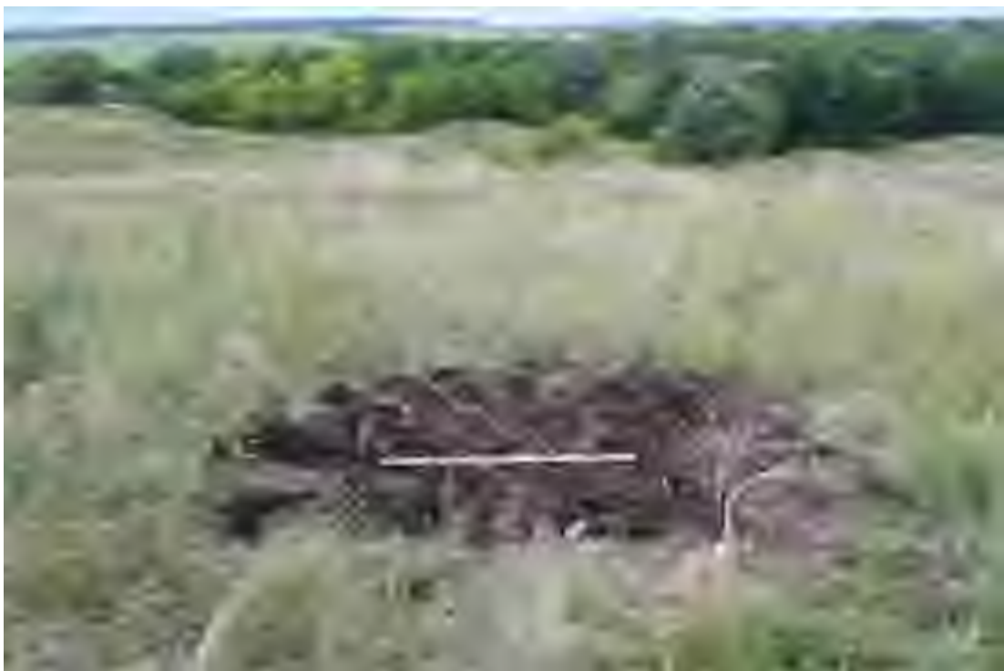
Рис. 24. Объект: «Газопровод межпоселковый от ГРС р.п. Тереньга - с. Тумкино- с. Назайкино- с. Красноборск с ответвлением на -с. Федькино, с. Байдулино» Теренгульского района Ульяновской области. Вид с С на консервацию шурфа 3.
